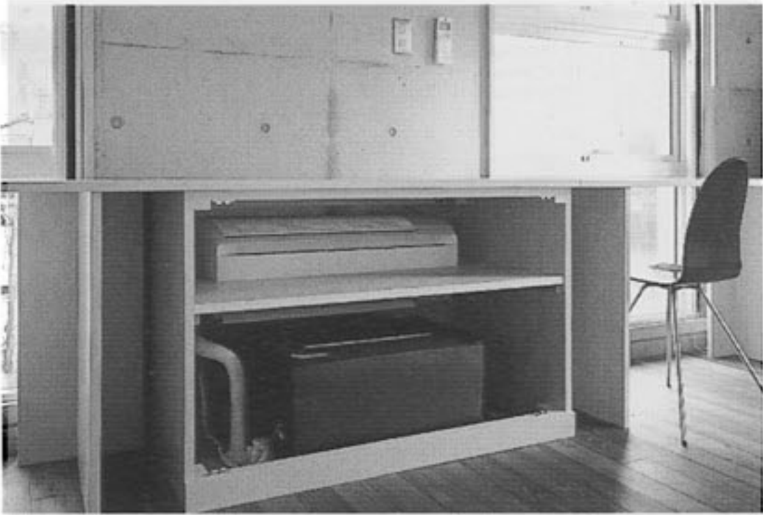
2階に設置されたブースターファン（下）と壁掛用エアコンを 組合わせた空気式床冷暖房（床放射冷暖房）
